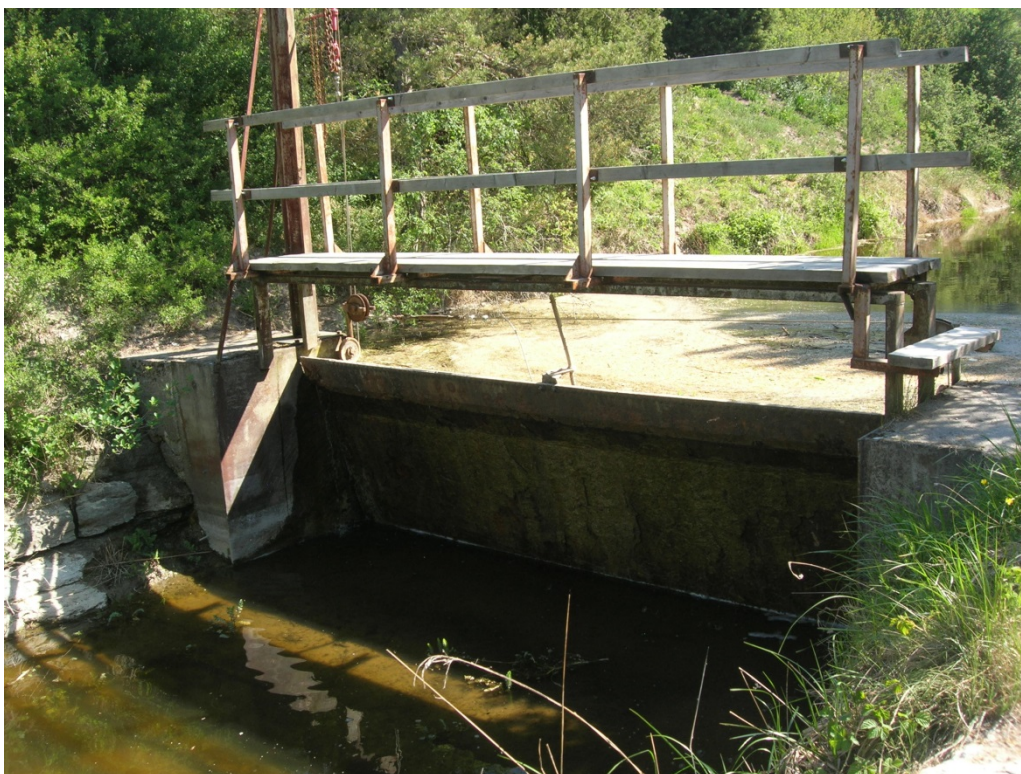
Luckan uppfälld. Kättingspel samt wirrar med trissor används för att fälla upp och fälla ner luckan. Martebo myrs dikningsföretag 1962
